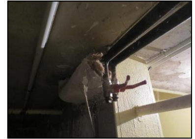
Photo N° 882 ECH-N°2 CALORIFUGEAGE -- DEGAGEMENT -1 Conduits de fluide Laine minérale + enveloppe plâtrée
